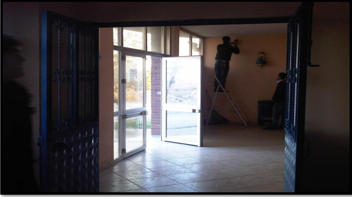
Acısu Cem Evi'nin elektrik sorunu çözülmeye çalışılmaktadır, Gökçen Çatlı Özen, 17.10.2011
